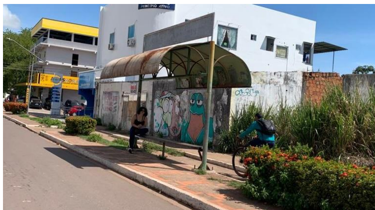
Foto 3.22 — Ponto de ônibus com estrutura deteriorada na Rua Salvador Diniz
