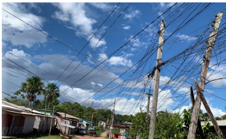
Foto 3.8 — Instalações elétricas no bairro Parque das Laranjeiras
