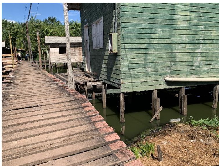
Foto 3.1 — Habitação sobre palafitas, com tubulação de esgoto exposta, localizada em área de ressaca no Bairro Provedor II
