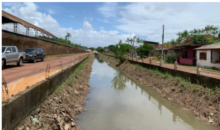
Foto 3.2 — Canal para manejo de águas pluviais
